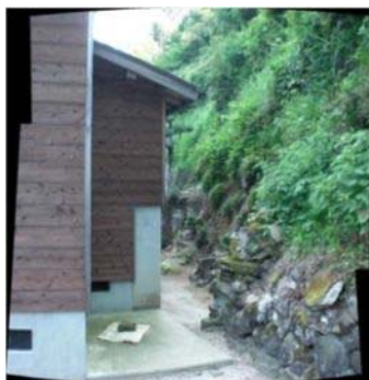
③斜面状況
