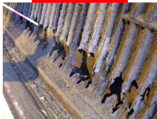
【写真-3 腐食状況】
