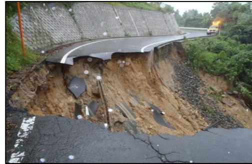
↑舞鶴宮津線（宮津市皆原）の路肩欠壊
