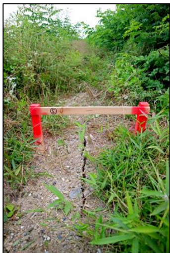
↑ 亀裂が入った天津神川の堤防（京田辺市）
