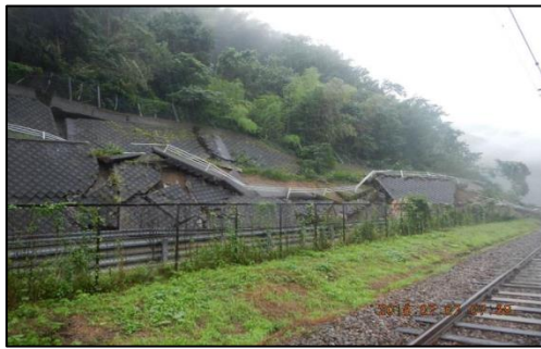
↑国道27号（舞鶴市真倉）の法面崩壊
