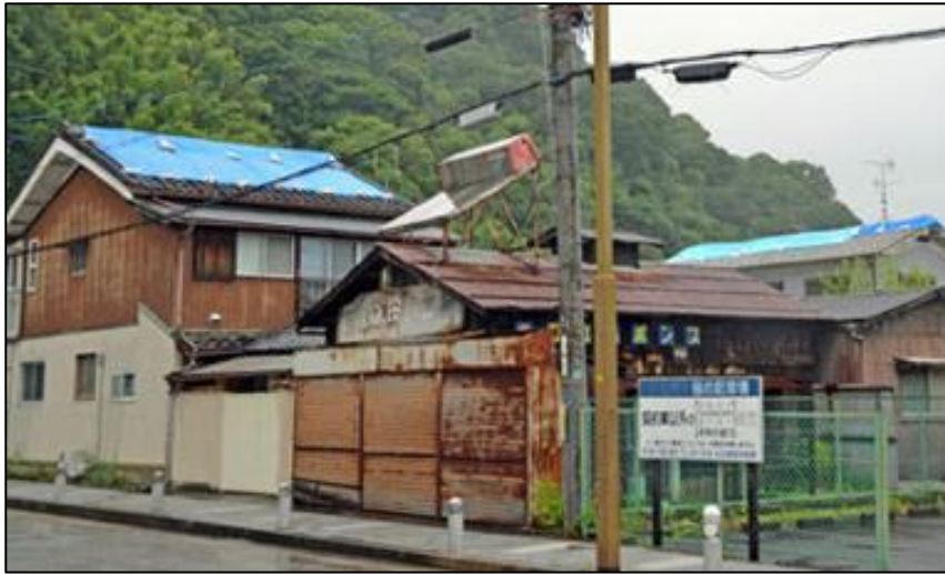
↑ 雨に備え損傷した屋根にブルーシートを被せた住宅（八幡市）
