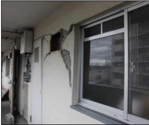
← 損傷した府営住宅男山美桜団地の壁（八幡市）
