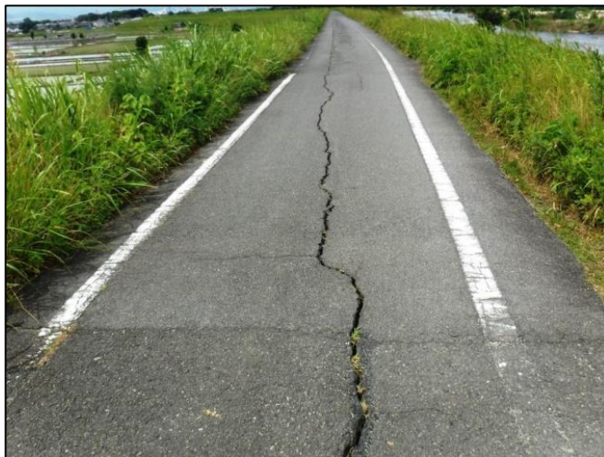
↑ 京都八幡木津自転車道線に生じたクラック（八幡市）
