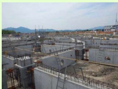
現場コンクリート量を抑えた プレキャスト工法を採用
