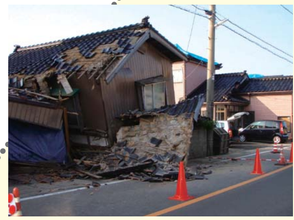
2007年7月の新潟県中越沖地震は震度6強を記録し多くの木造住宅が倒壊した(写真提供: 新潟県)
