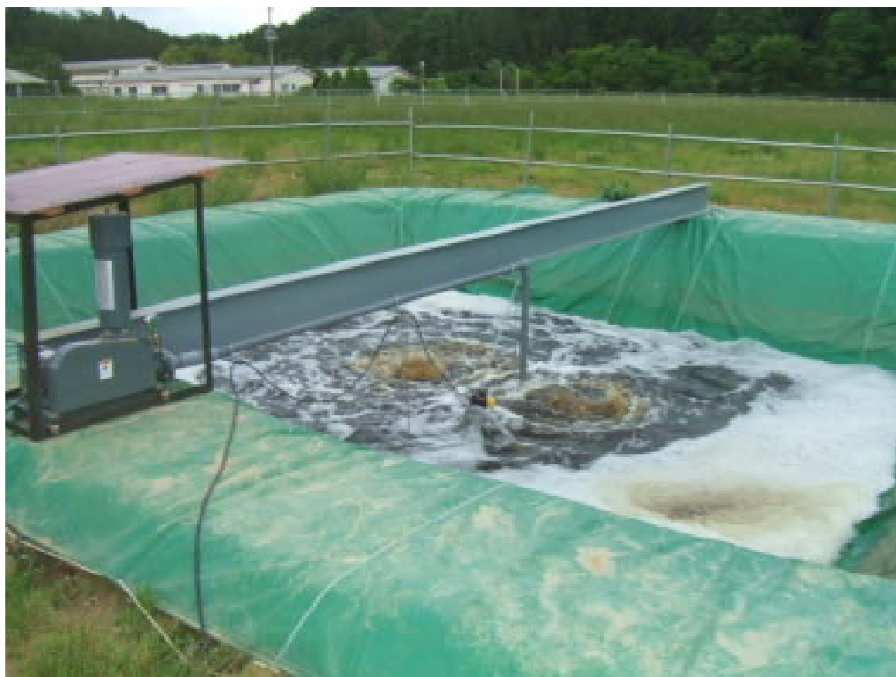
汚水処理施設での運転状況
