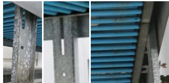
図 7 集卵バーコンベアの柱と屋根の隙間
