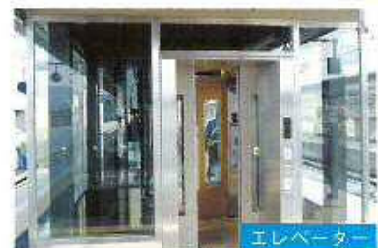
エレベーター
