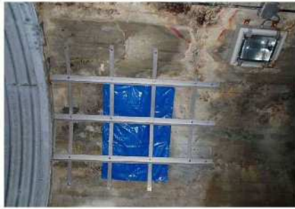
写真-3.1.1 等辺山形鋼等による応急対策事例
