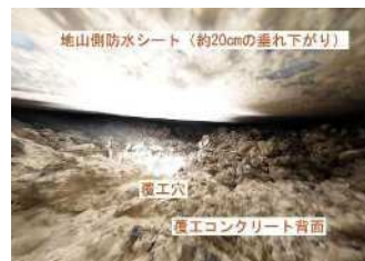
写真-2.2.4 空洞内部の状況(S031)
