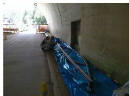
資材の保管状況
