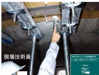
現場技術員 S008+0.71 確認孔流出確認
