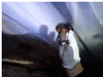
S038+5.9 充填検知センサー設置状況
