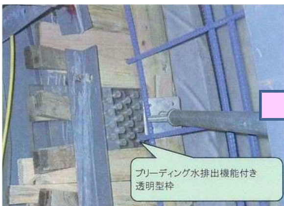
写真 7.1.19 透明型枠の事例
