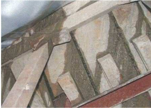
写真 7.1.15 木製型枠の隙間を空けた事例
