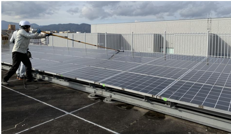
図10 京都府本庁舎2号館屋上に設置した太陽光パネルの洗浄作業の様子
