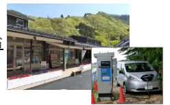
EV車等への給電設備
