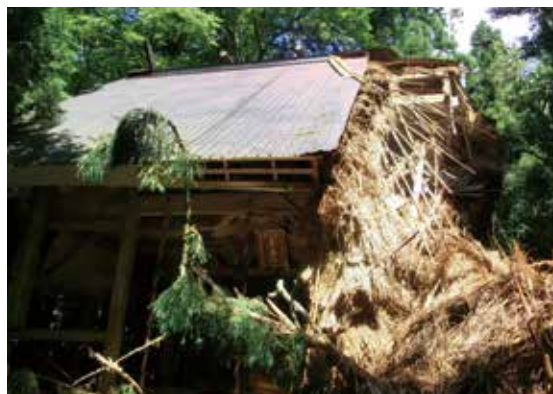
半壊した本殿及び覆屋
