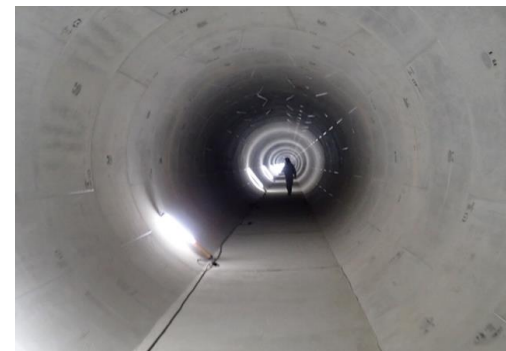
いろは呑龍トンネル 南幹線
