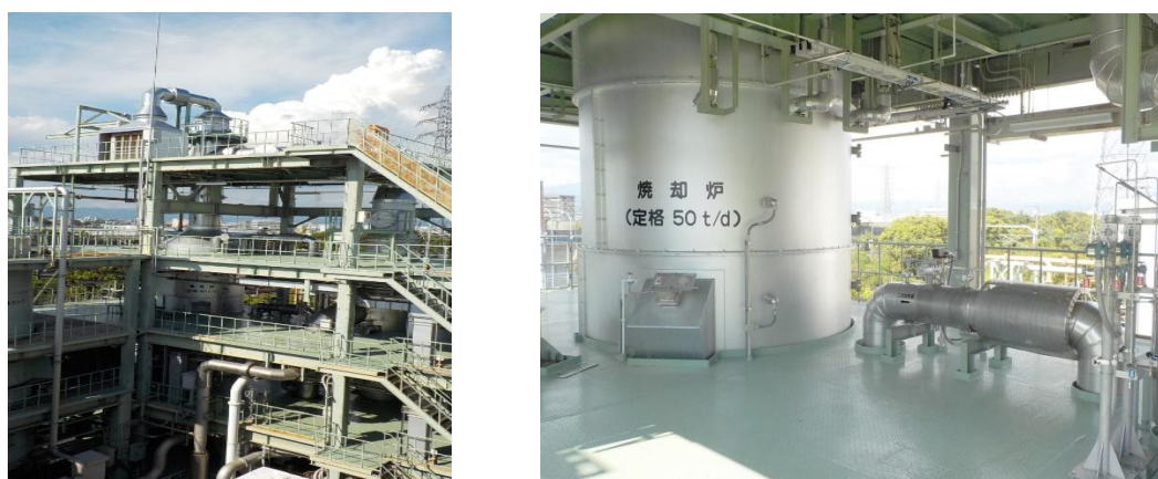
図 5.2 3号焼却炉（左：全景、右：焼却炉本体）
