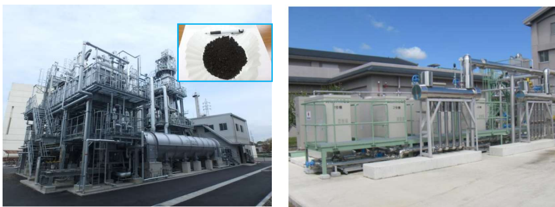
図 2.17 固形燃料化施設（左：洛西）と消化ガス発電設備（右：木津川上流）
