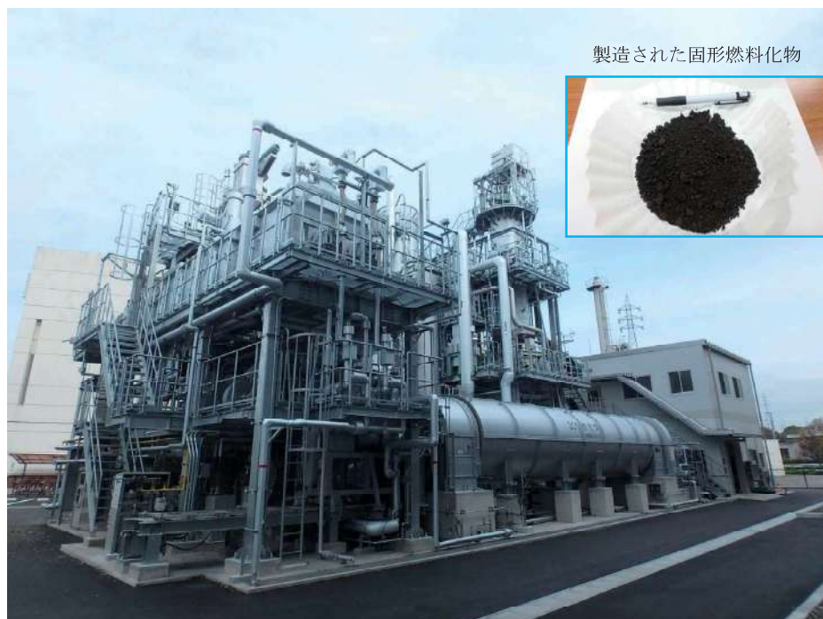
下水汚泥固形燃料化施設
