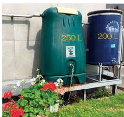
雨水貯留施設（府庁 2 号館屋上）
