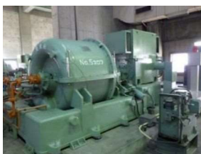
送風機設備（更新）
