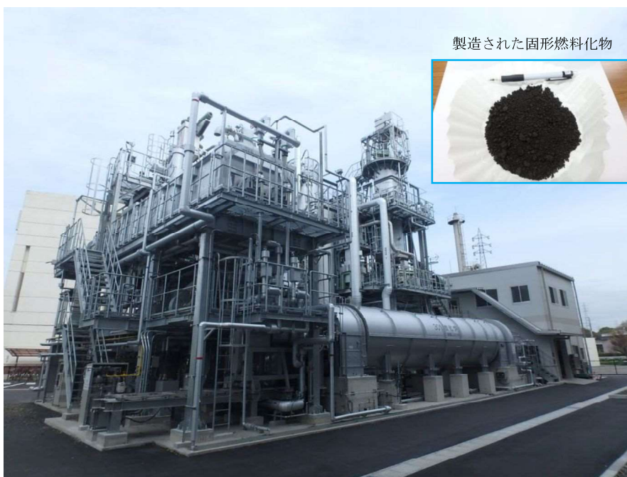
下水汚泥固形燃料化施設
