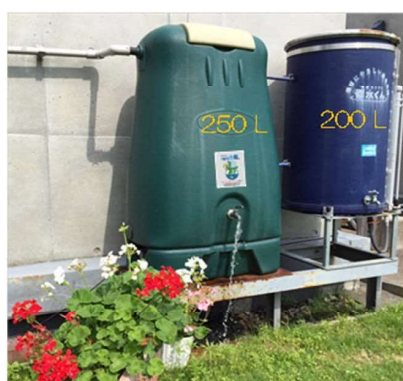
雨水貯留施設（府庁2号館屋上）
