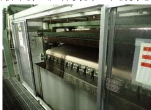
汚泥脱水機設備（更新）
