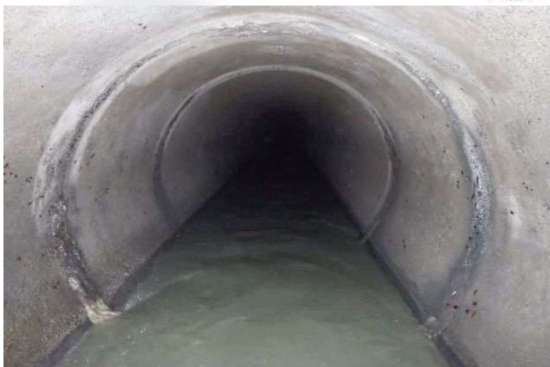
下水道管路の全国特別重点調査より
