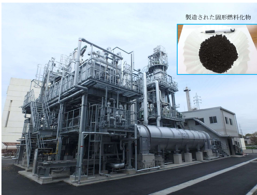
下水汚泥固形燃料化施設
