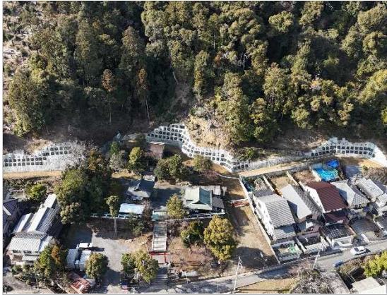
松室（京都市西京区） 土砂防護柵
