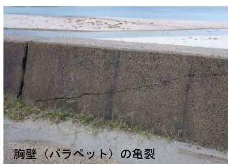
図 1-3-7 護岸の老朽化
