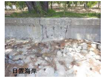
図 1-5-7 老朽化した海岸保全施設
