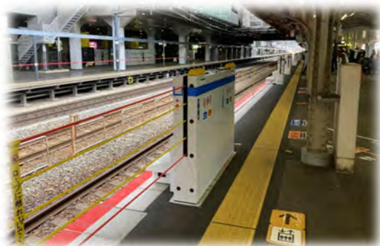
鉄道駅舎バリアフリー化設備整備事業 (JR京都駅ホーム柵整備)
