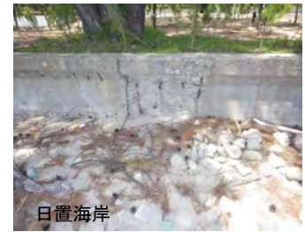
図 1-5-7 老朽化した海岸保全施設
