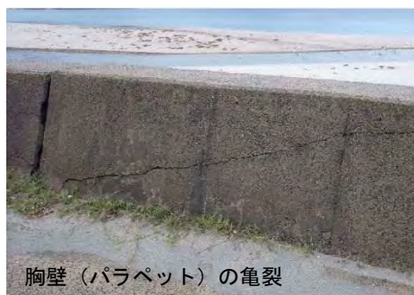
図 1-3-7 護岸の老朽化
