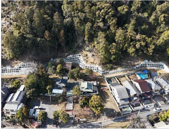
松室（京都市西京区） 土砂防護柵
