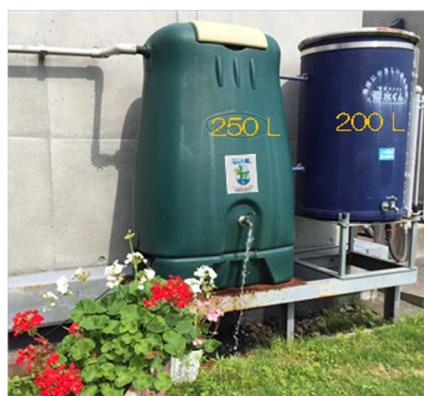
設置例 1 (府庁2号館屋上)
