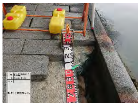
護岸の空洞化
