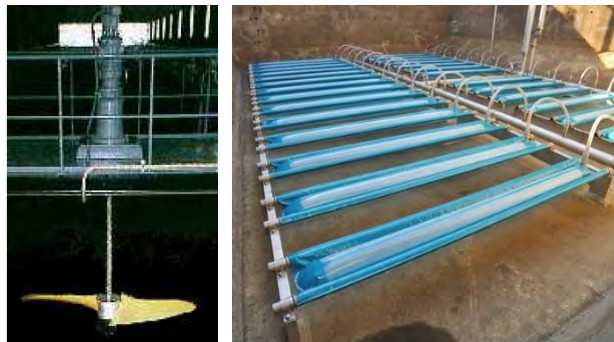
水処理設備（更新）
