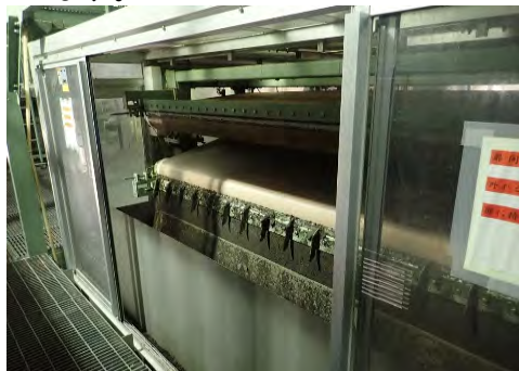
汚泥脱水機設備（更新）
