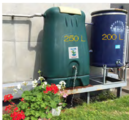
設置例 1 (府庁2号館屋上)
