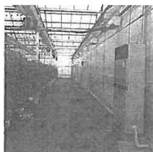
ヒートポンプ
