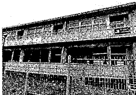
震災遺構 浪江町立 請戸小学校 津波の被害を受けたままの状況です
