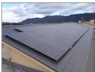
府営住宅等における 太陽光発電設備の設置例
