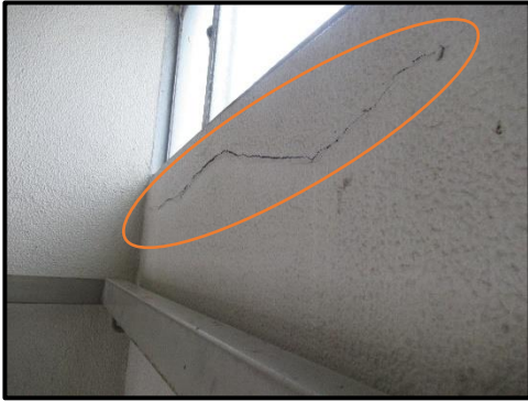
共用部分の壁の亀裂
