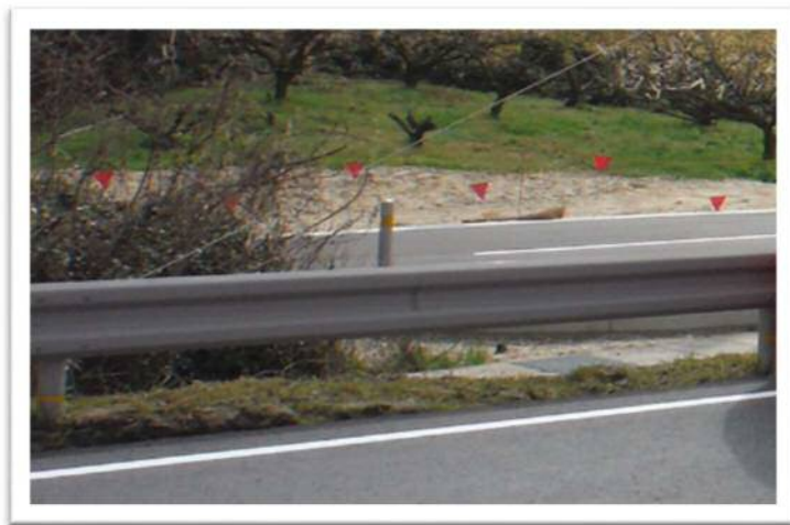
【写真-4 隣接工区での設置状況（グレーベージュ）】
