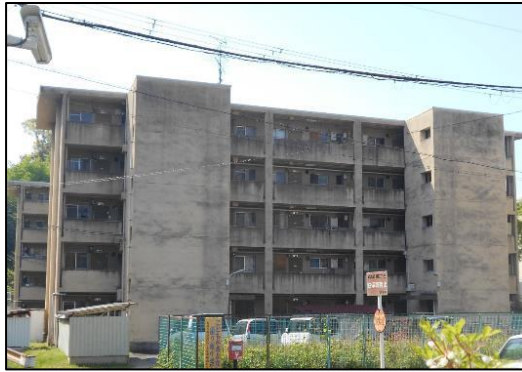
【写真－1 建物の老朽化】
