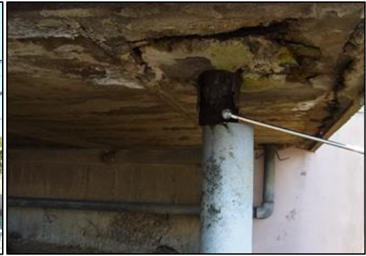
【写真－2 給排水管の不具合】
