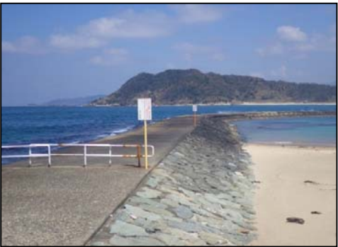
浅茂川海岸 損傷による立入禁止措置
