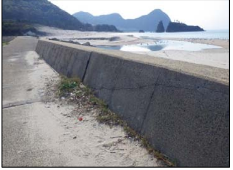
上野海岸 擁壁クラック
