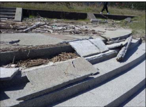
由良海岸 蹴上剥離
