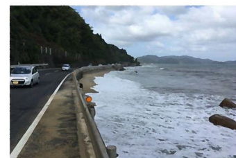
【写真-3 現況道路 (海砂打ち上げ状況)】
