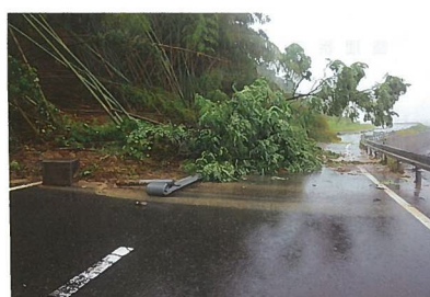
【写真-4 山側崩壊 (H30. 7. 7 連続雨量 439mm)】
