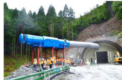
【写真-5 送風機の例】
