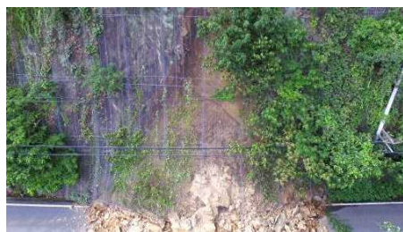
写真-4 国道163号落石・崩土
