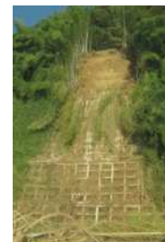
【写真-5 山側崩壊 (H25. 9. 15 台風)】
