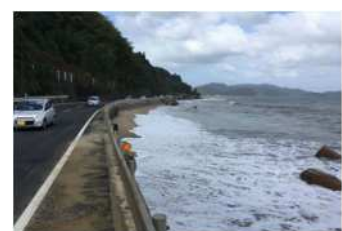
【写真-3 現況道路 (海砂打ち上げ状況)】
