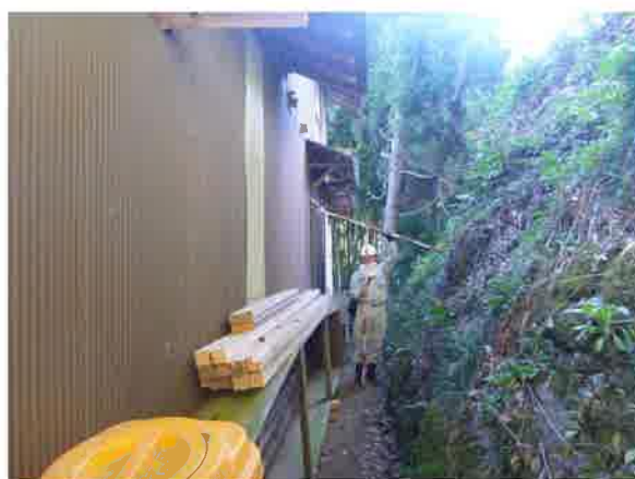
【写真番号⑭】 8No.3 付近の状況
