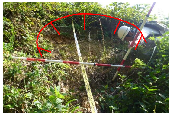
【写真番号⑦】 NO. 12 付近の表層崩壊跡 (近景)
