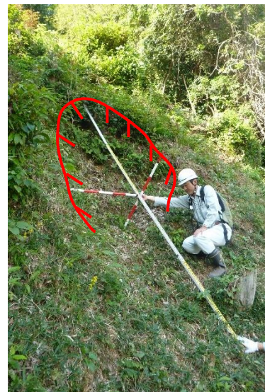
【写真番号⑨】 測点 NO. 21+5 付近の表層崩壊跡
