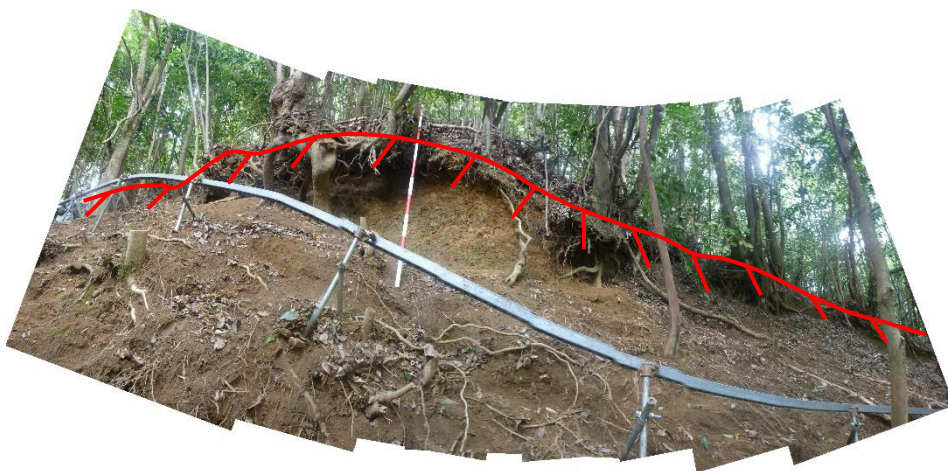
【写真番号⑮】 測点 NO. 41+5～NO. 42 付近 斜面上方の表層崩壊跡
