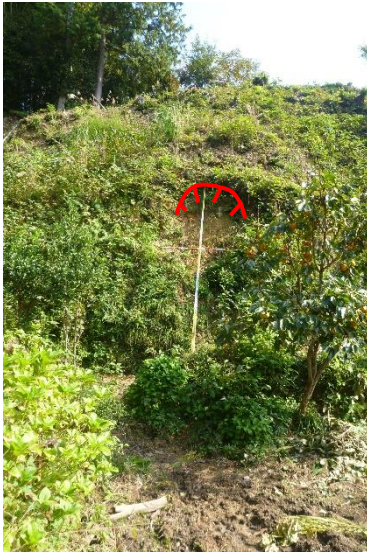
【写真番号⑥】 NO. 12 付近の表層崩壊跡
