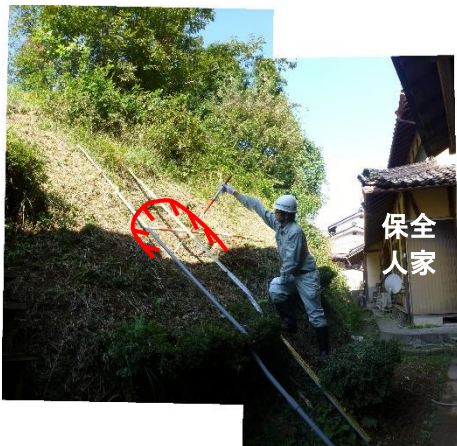
【写真番号⑧】 測点 NO. 17+5 付近の表層崩壊跡
