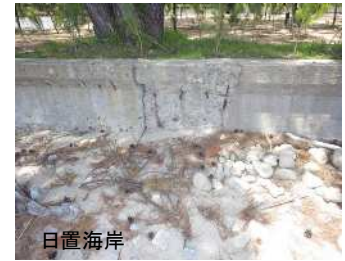
図 1-5-7 老朽化した海岸保全施設
