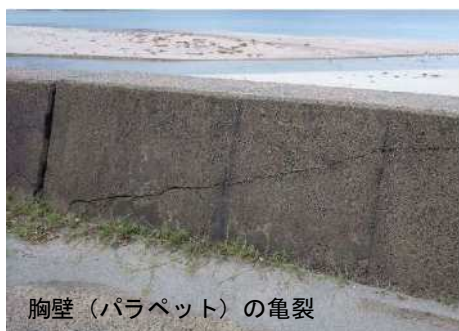
図 1-3-7 護岸の老朽化
