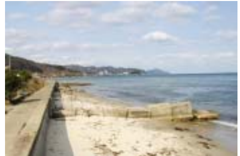
老朽化した海岸保全施設
