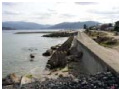
老朽化した既設護岸
