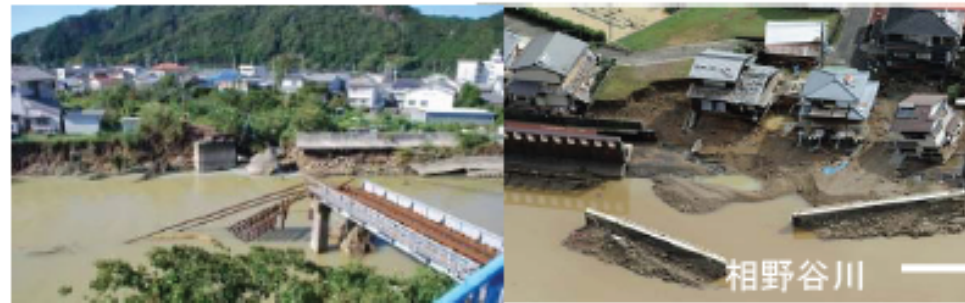
紀勢線 なち 那智川橋りょう流出
