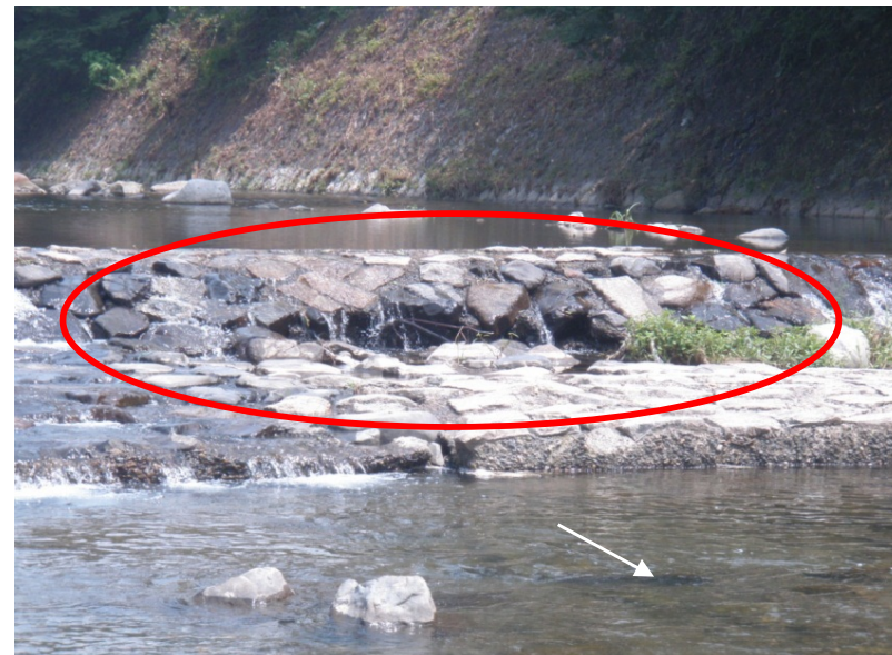
損傷している落差工(高野川)
