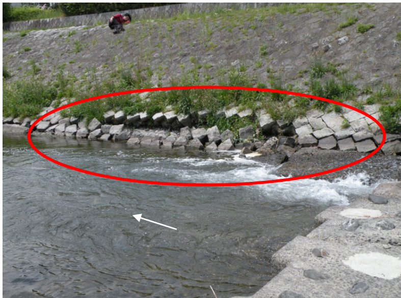
損傷している護岸(鴨川)
