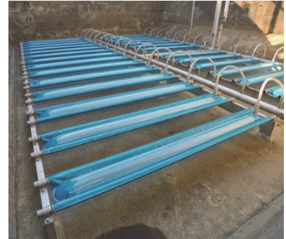
水処理設備（更新）
