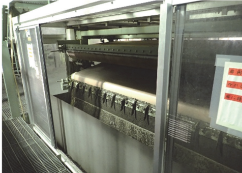
汚泥脱水機設備（更新）
