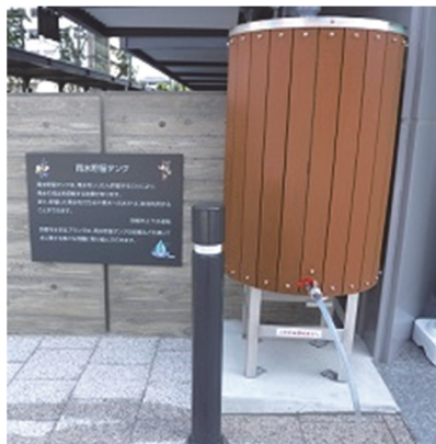
設置例 2 （京都市上下水道局）
