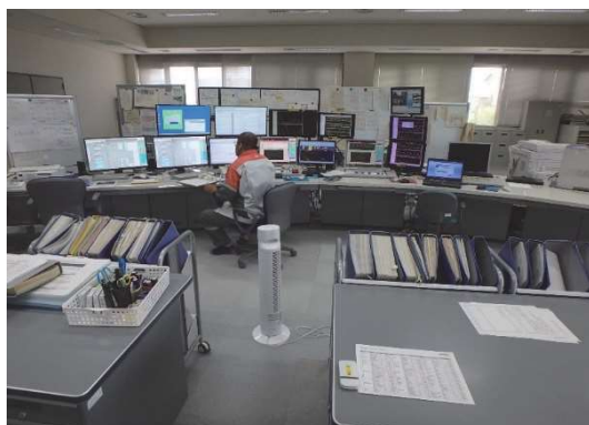
監視制御設備
