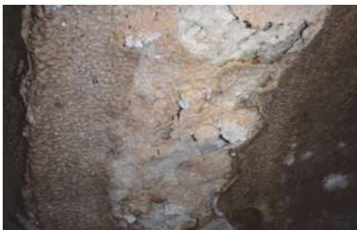
管渠の腐食状況
