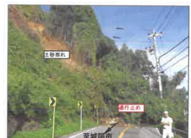
【被災の様子 平成25年9月】
